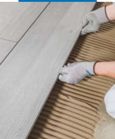
Aanbrengen van tegels met een houteffect op een met Mapelastic waterdicht gemaakte ondergrond
